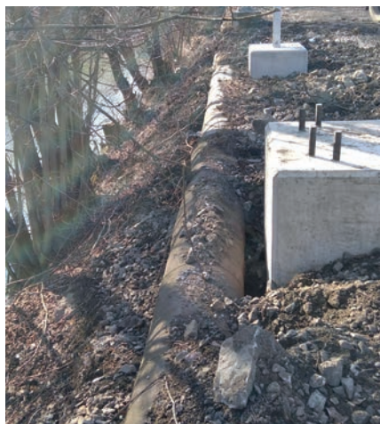
Stávající kanalizační výtlak
