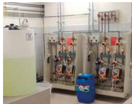
Sklad chlornanu se zásobní nádrží a dávkovací stanicí - čerpadla ProMinent s nástěnným panelem, kde jsou přepojovací uzly s výtlaky do dávkovacích tras
