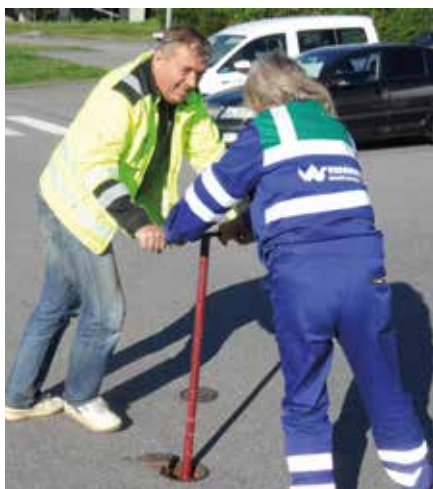
Potrubí muselo být před začátkem opravy odstaveno z provozu
