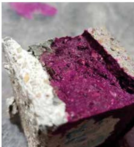
Vzorek Mapegrout T60 od MAPEI – Pomocí FF-testu bylo prokázáno, že po odstranění nesoudržných částic je beton neporušen síranovou korozí
