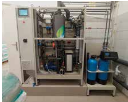
Pohled na celé výrobní zařízení chlornanu
