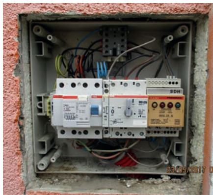
Pohled na rozvaděč – původní zapojení
